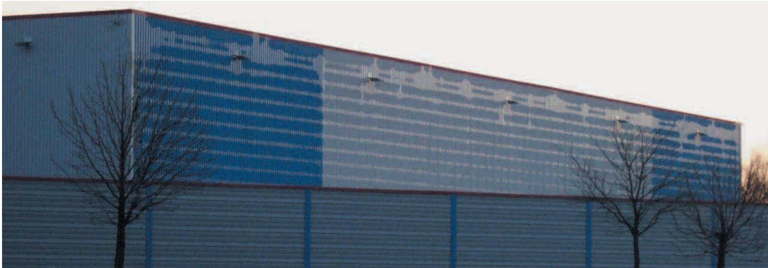
Wärmebrücken im Bereich durchgehender Metallstege
